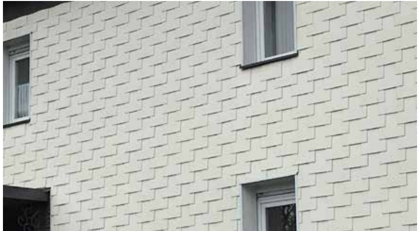
Misstand: Materialität der Fassade
