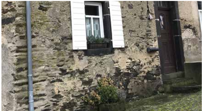
Modernisierungs- und instandsetzungsbedürftiges Gebäude mit hohem Bedarf
