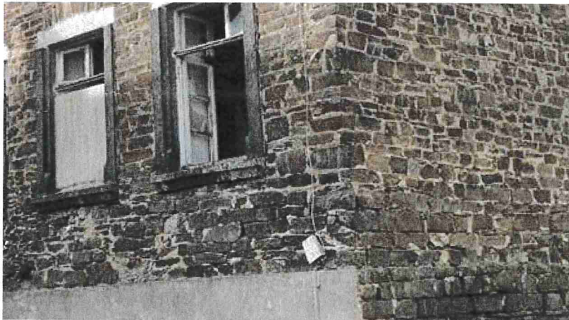
Modernisierungs- und instandsetzungsbedürftiges Gebäude mit hohem Bedarf
