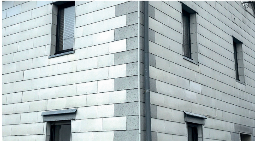
Missstand: Materialität der Fassade
