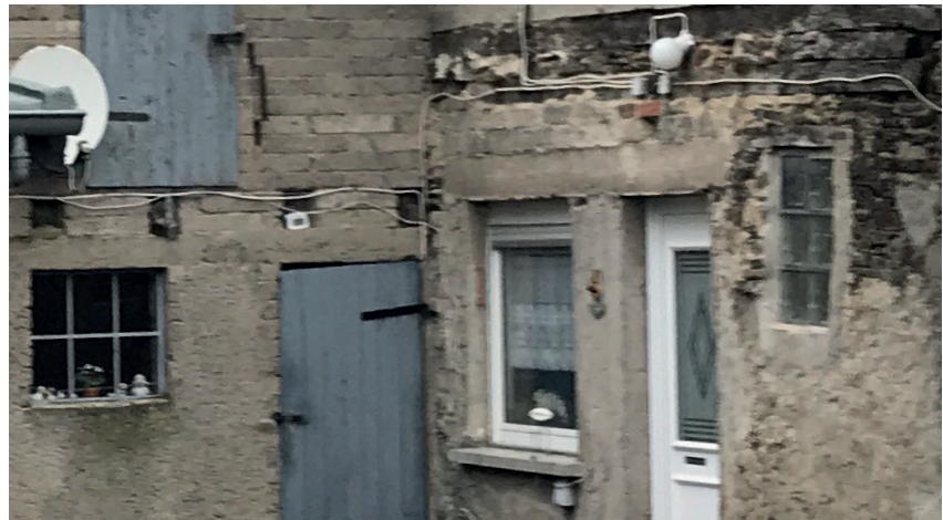
Modernisierungs- und instandsetzungsbedürftiges Gebäude mit hohem Bedarf
