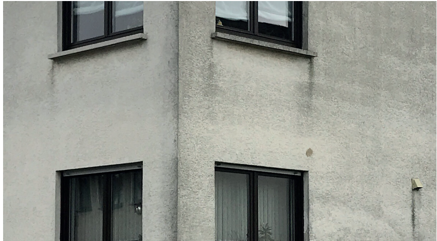
Modernisierungs- und instandsetzungsbedürftiges Gebäude mit mittlerem Bedarf
