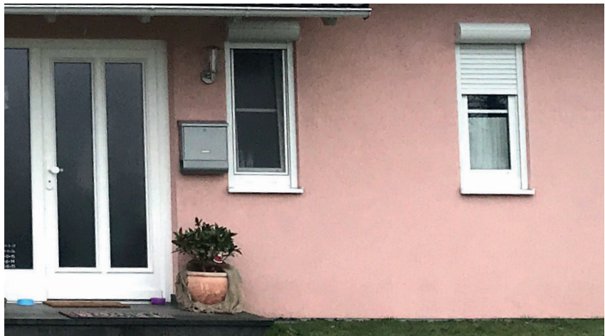
Modernisierungs- und instandsetzungsbedürftiges Gebäude mit geringem Bedarf
