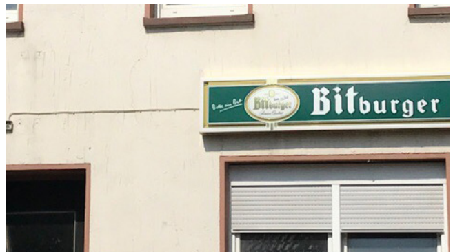
Negativ: Werbeanlagen mit offenliegenden Kabeln
