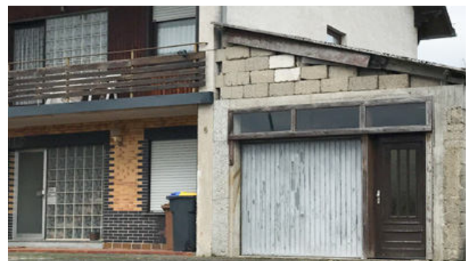
Negativ: angebauter Carport ohne Bezug zum Hauptgebäude
