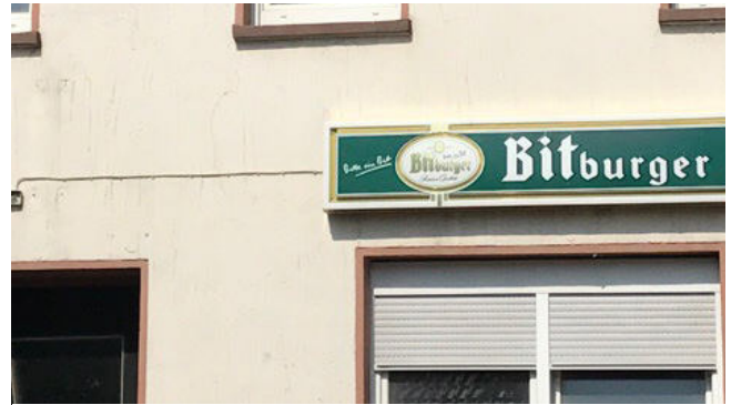
Negativ: Werbeanlagen mit offenliegenden Kabeln
