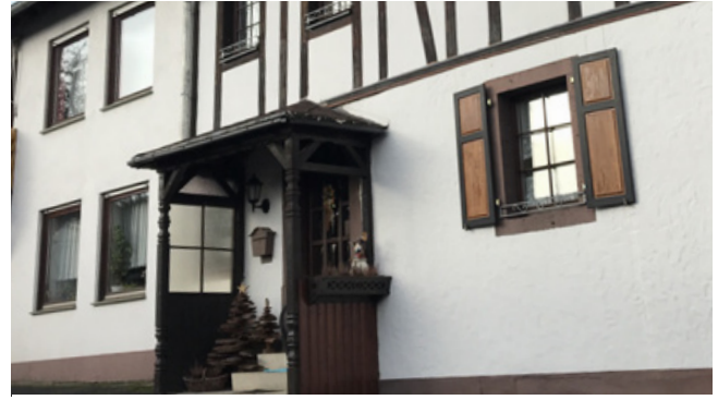
Positiv: das Vordach fügt sich harmonisch in den Bestand ein (Material/ Farbe)
