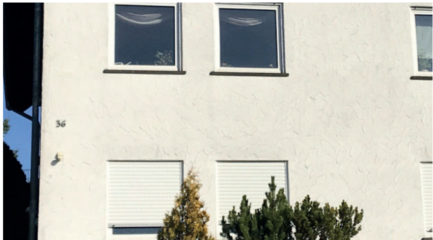
Modernisierungs- und instandsetzungsbedürftiges Gebäude mit geringem Bedarf
