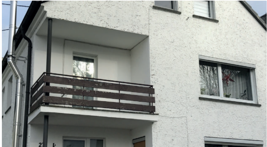
Modernisierungs- und instandsetzungsbedürftiges Gebäude mit mittlerem Bedarf
