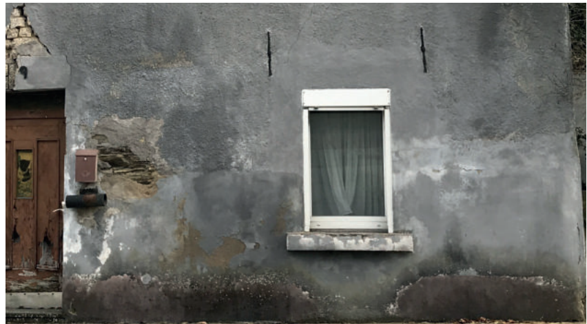
Modernisierungs- und instandsetzungsbedürftiges Gebäude mit hohem Bedarf
