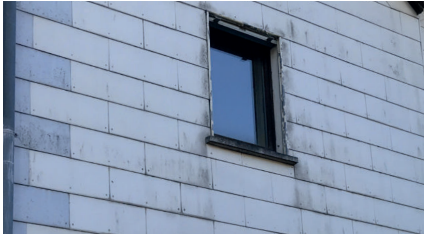
Missstand: Materialität der Fassade
