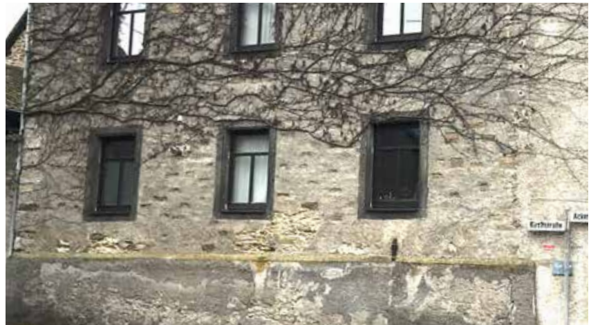
Modernisierungs- und instandsetzungsbedürftiges Gebäude mit hohem Bedarf
