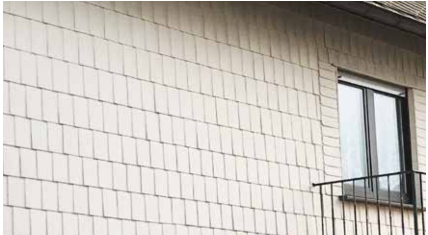
Misstand: Materialität der Fassade
