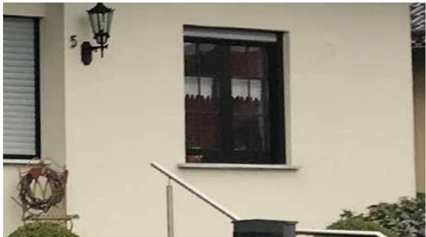
Modernisierungs- und instandsetzungsbedürftiges Gebäude mit geringem Bedarf
